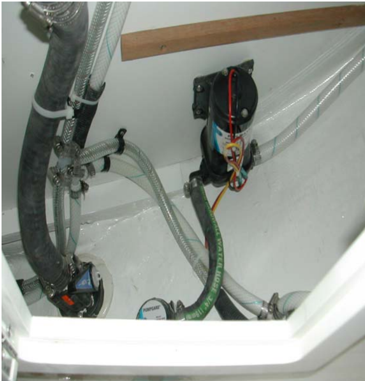
Jabsco Par Max 3 shower sump pump below head sink area
